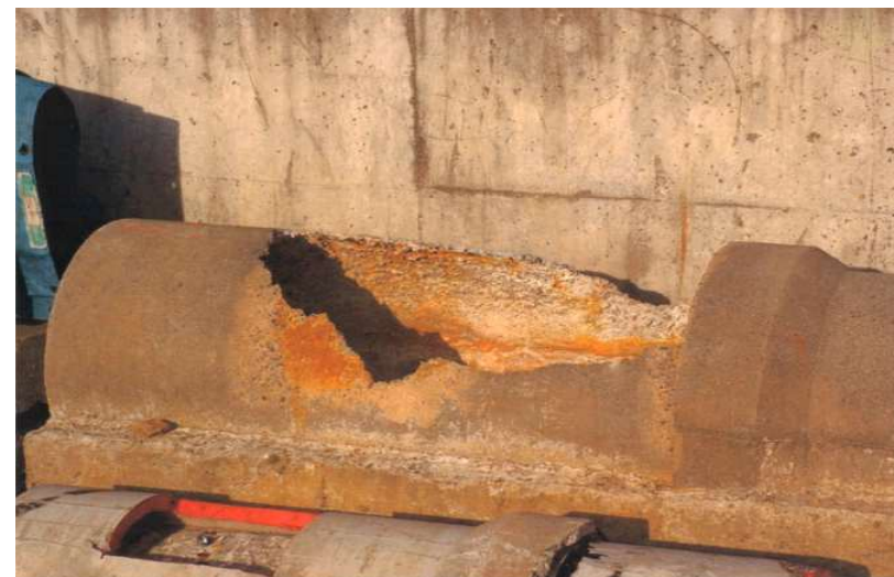
腐食による破損
