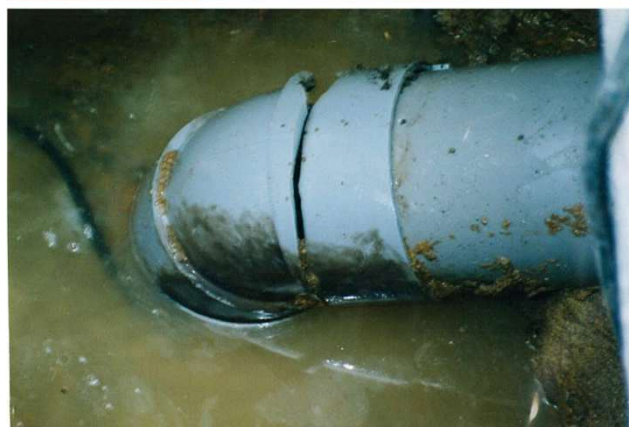
塩ビ管継手部のクラック
